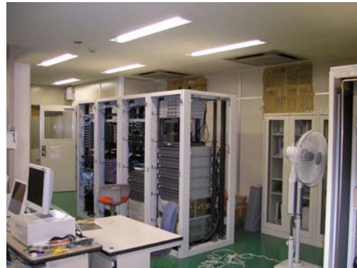
図 4.11: コンピュータ室
