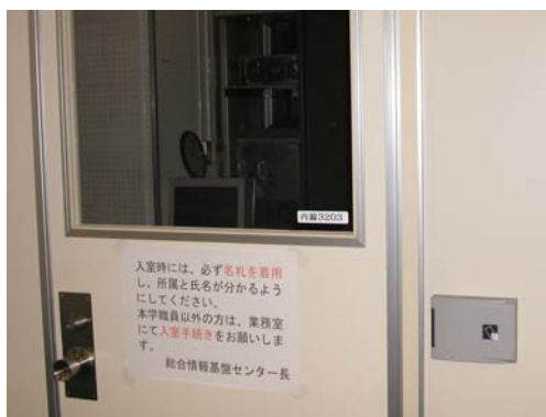
図 4.10: コンピュータ室入り口の入退室管理
