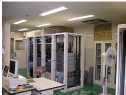
図 4.9: コンピュータ室
