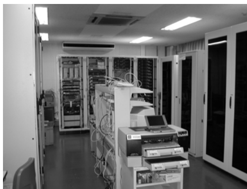
図 3.9: コンピュータ室
