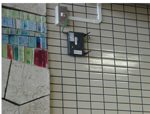
附属図書館に設置している無線LAN装置
