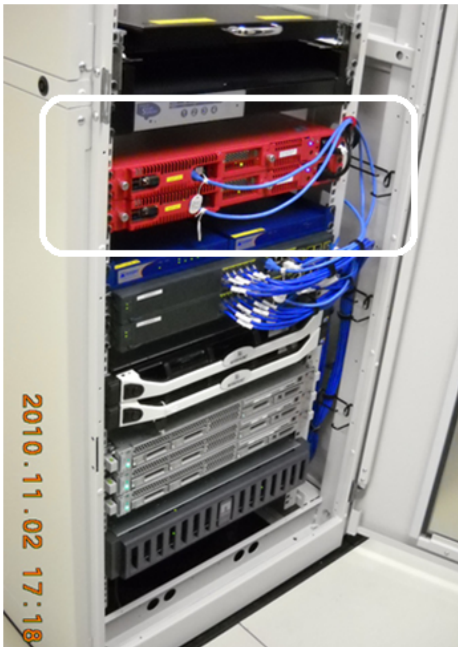
図1 業者にて稼働中のメール系サーバ群。ラックの中に、教職員用も一緒に入っています。今回の学生用および部局用の対策サーバは、四角で囲んでいる2台です。
