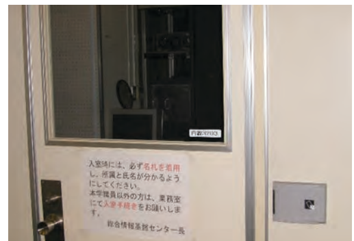
図 4.6 コンピュータ室入口の入退室管理
