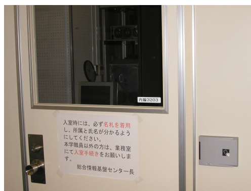
図 4.9: コンピュータ室入り口の入退室管理
