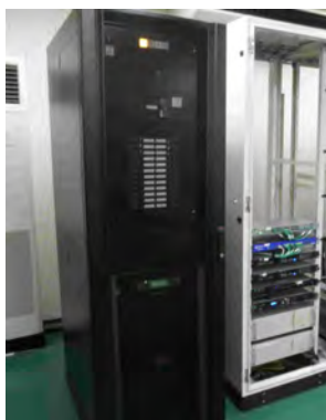
図 4.9: 新キャンパス情報ネットワークシステムのラック配置。一番左が無停電電源装置
