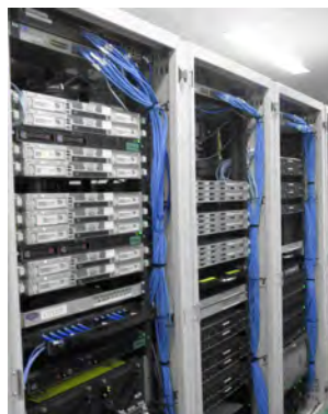
図 4.12: コンピュータ室
