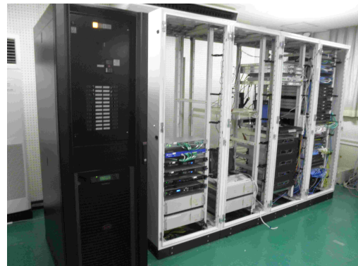
図 4.9: 新キャンパス情報ネットワークシステムのラック配置。一番左が無停電電源装置
