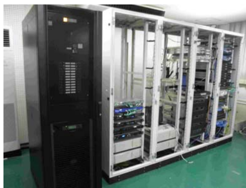
図 4.9: 新キャンパス情報ネットワークシステムのラック配置。一番左が無停電電源装置
