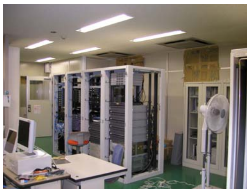
図 4.9: コンピュータ室
