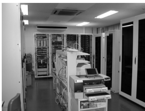
図 4.9: コンピュータ室
