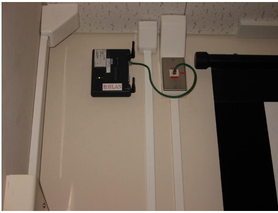
図 1: 教室に設置された無線 LAN のアクセスポイント
